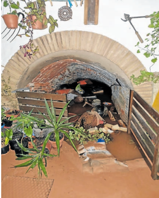
La bodega quedó totalmente anegada de agua por la avería. A.A.
