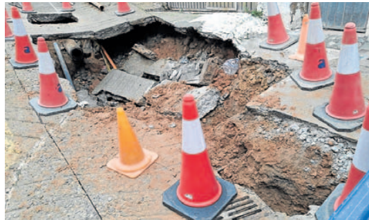
El Ayuntamiento va a estudiar el hundimiento para actuar en la vía. A.A.
